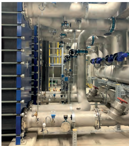
■ Blick in die See-Energie Zentrale Seefeld in Horw. Über das See-Energie Netz werden künftig Gebäude mit Wärme, Kälte sowie Warmwasser versorgt.
