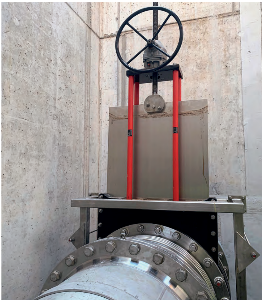
■ Die See-Energie Zentrale Seefeld in Horw wurde Ende 2020 in Betrieb genommen. Geplant ist, im Endausbau jährlich 55 Gigawattstunden Energie zu produzieren.
