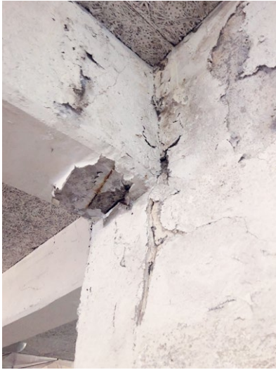
Bsp. für schadhafte Stahlbeton © suisseplan
